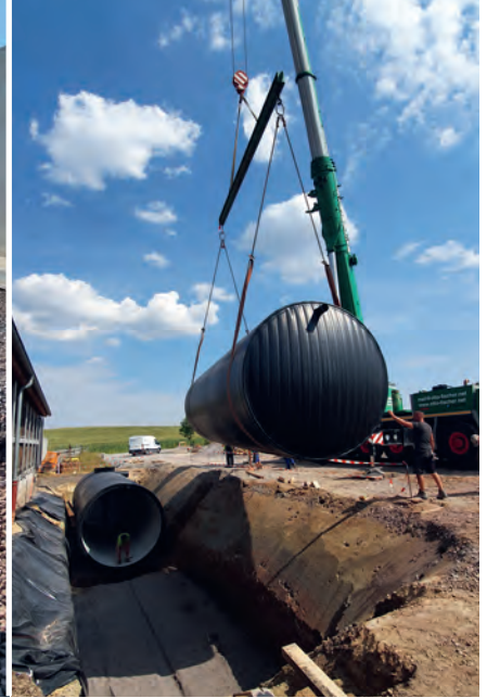
Die Dicke der Doppelwand betrug ca. 25 cm, wodurch der Behälter äußerst robust ist.
